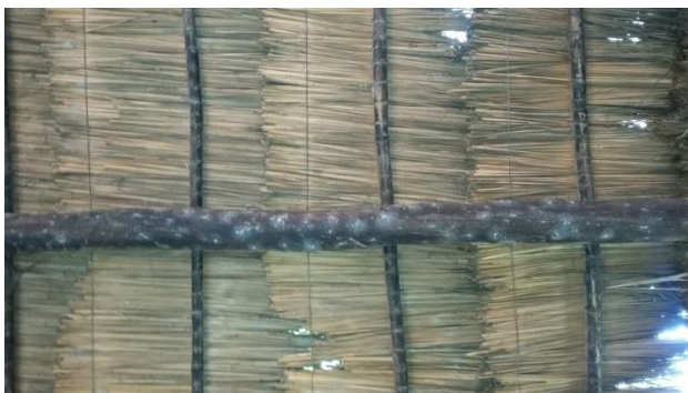
Detalle de afectación de moho en semicubierto
